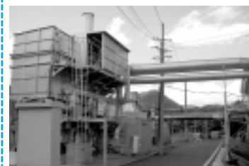
蓄熱式燃焼脱臭装置
